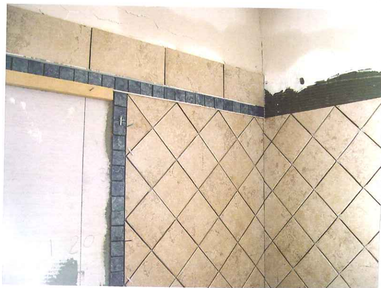
(ci-dessus) La planéité des parois permet l'application directe de tout type de revêtement. Ici, les faïences des salles de bains.
